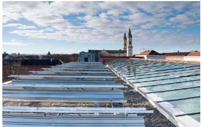
▲ Neue Photovoltaikanlage auf dem Dach der LMU: Im Zuge der Renovierung der Juristischen Fakultät wurde auf dem Dach des Gebäudes am Professor-Huber-Platz eine Photovoltaikanlage installiert. Etwa 9930 kWh Strom kann die LMU damit pro Jahr ins Stromnetz einspeisen.
